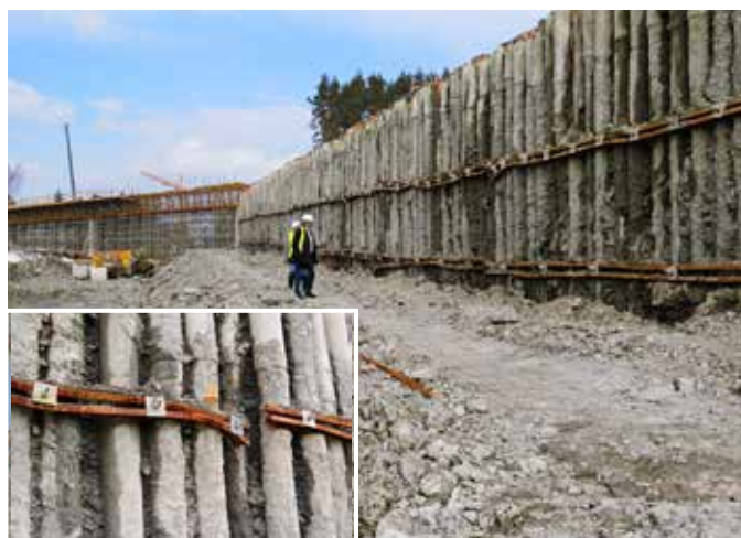
Ryc. 6. Uszkodzona konstrukcja z uformowaną przyporą ratunkową i przeciężony rząd mikropali kotwiących (widoczne deformacje)
