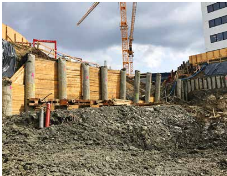
Ryc. 2. Widok zniszczonej konstrukcji ścianki berlińskiej na odcinku kotwionym
