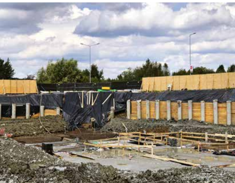
Ryc. 1. Widok zniszczonej konstrukcji ścianki berlińskiej wspornikowej
