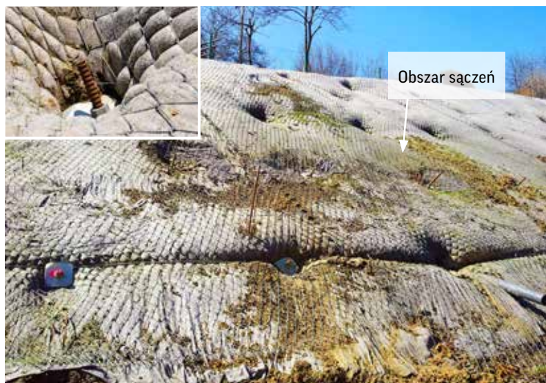
Ryc. 3. Widok ogólny zdeformowanej skarpy gwoździwanej ze szczegółem przeciążonego gwoźdźca gruntowego i siatki stalowej
