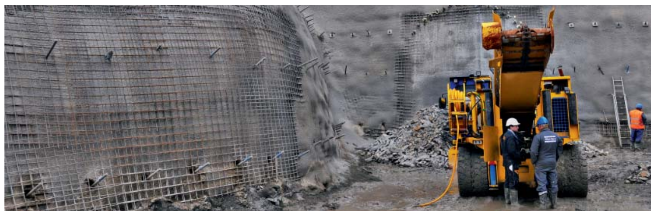
Fot. 4. Portal południowy tunelu na odcinku C2 z widocznym zarysem kaloty tunelu ewakuacyjnego
