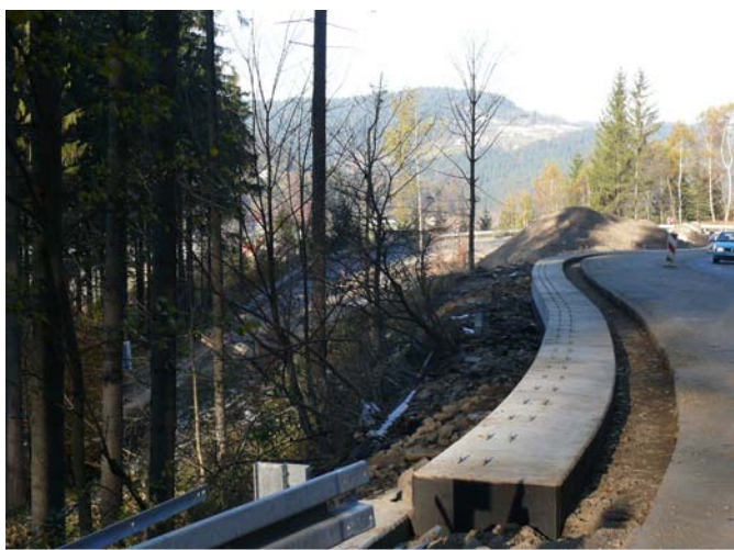
Osuwisko nr 1. Widok górnej bariery mikropalowej
