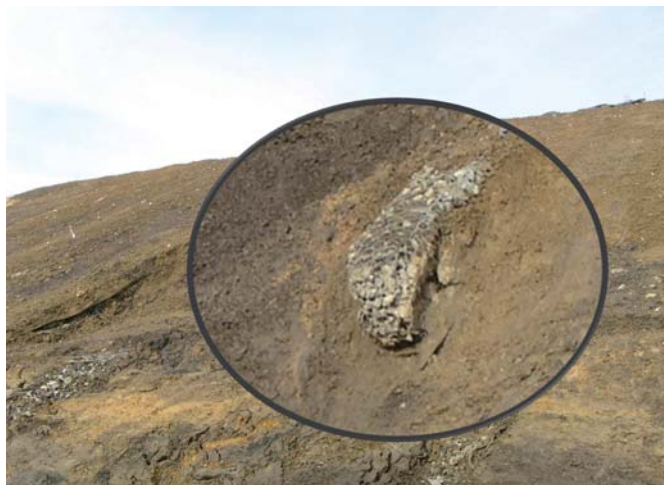
Ryc. 16. Widok zerwanego drenażu
