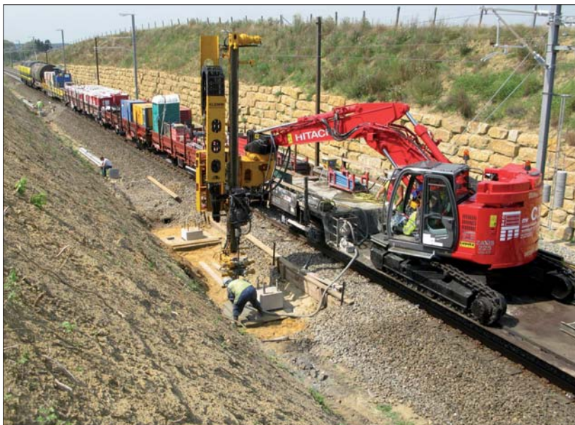
Fot. 2 | Wykonywanie mikropali pod słupy trakcyjne, widoczne zaplecze budowy zamieszczone na platformie pociągu roboczego
