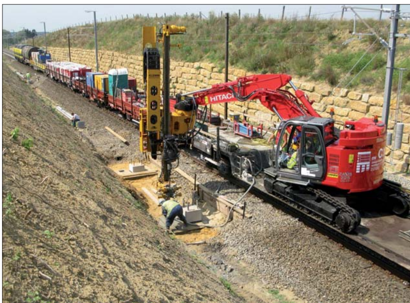
Fot. 2 | Wykonywanie mikropali pod słupy trakcyjne, widoczne zaplecze budowy zmieszczane na platformie pociągu roboczego
