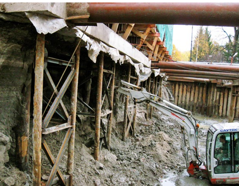
Ryc. 1. Głębinie wykopu dla nowej kondygnacji pod budynkiem teatru – podchwycenie stężonymi grupami mikropali
