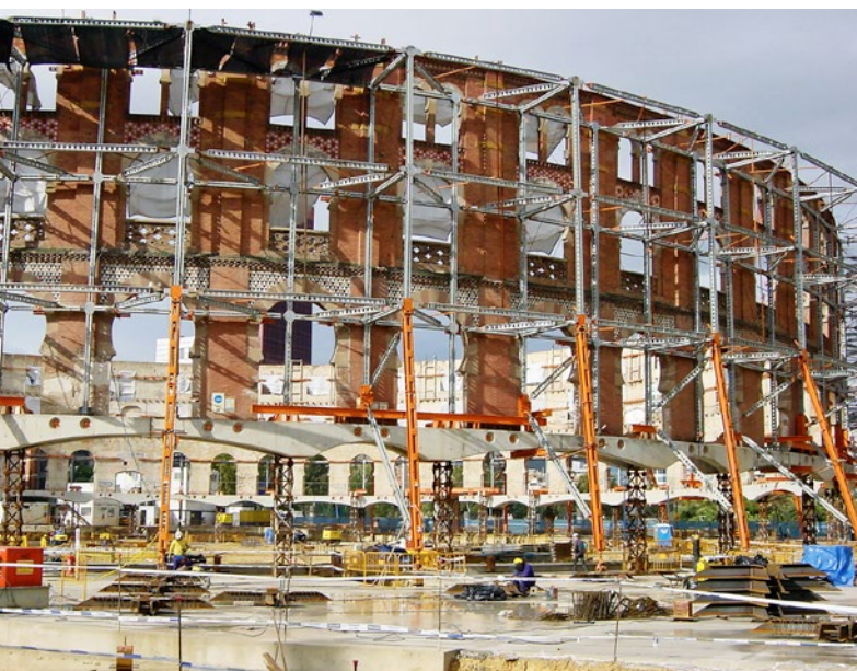
Ryc. 2. Podchwycenie elewacji wieżami mikropalowymi w celu wykonania kondygnacji podziemnych pod dawną areną walki byków
